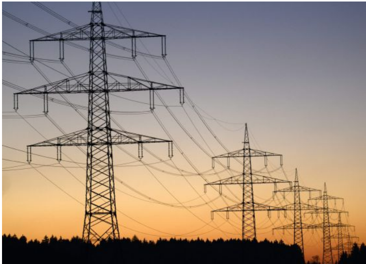
Vista de varios postes eléctricos / EFE
