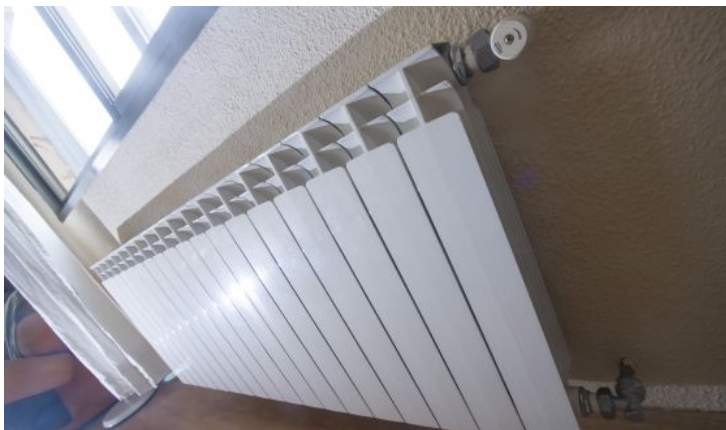
Un radiador de agua, calefacción central, en una vivienda. / SANTI BURGOS
