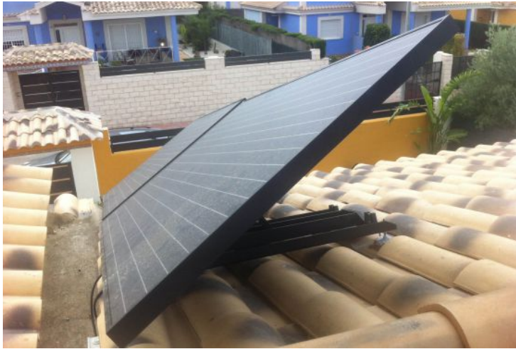
Paneles solares fotovoltaicos en una vivienda de Murcia.
